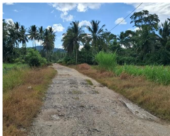
Gambar 1 b (Ruas Jalan Loewa-Tinomu sepanjang 3,430 km). Kondisi aspal namun sudah berlubang
